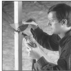
Fixer le support de montage (NB).
